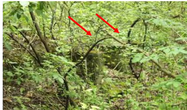
Fundamentreste der Brücke über das Schwabenbächl
